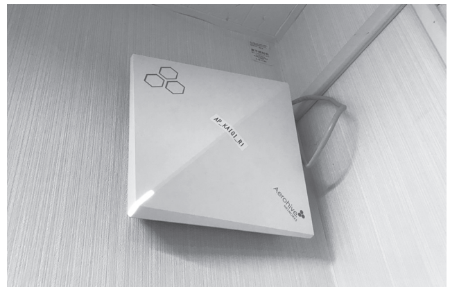
図1 設置された Access Point：Aerohive AP250
